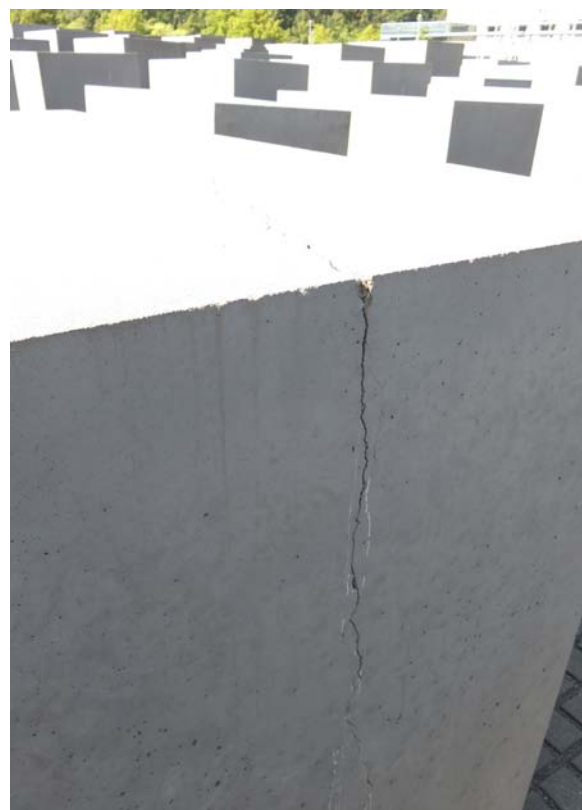
Figura 8. Berlín. Monumento a los judíos de Europa asesinados, obra de Peter Eisenman y Buro Happold (2003-2005). (Fotografía Javier Rivera, 2016). Con problemas de agrietamiento y pérdida de materia. Aquí se aprecia uno de los paradigmas de la arquitectura y escultura contemporáneas. Los materiales se dilatan y se resquebrajan y la necesidad de restauración dentro de la disciplina plantea de nuevo criterios de reintegración o de manifestar documentalmente los daños sufridos.
